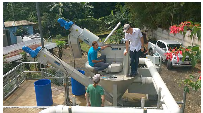
Equipos nuevos para el tratamiento de aguas servidas en la planta de depuración "La Trinidad", ciudad de Alajuela
